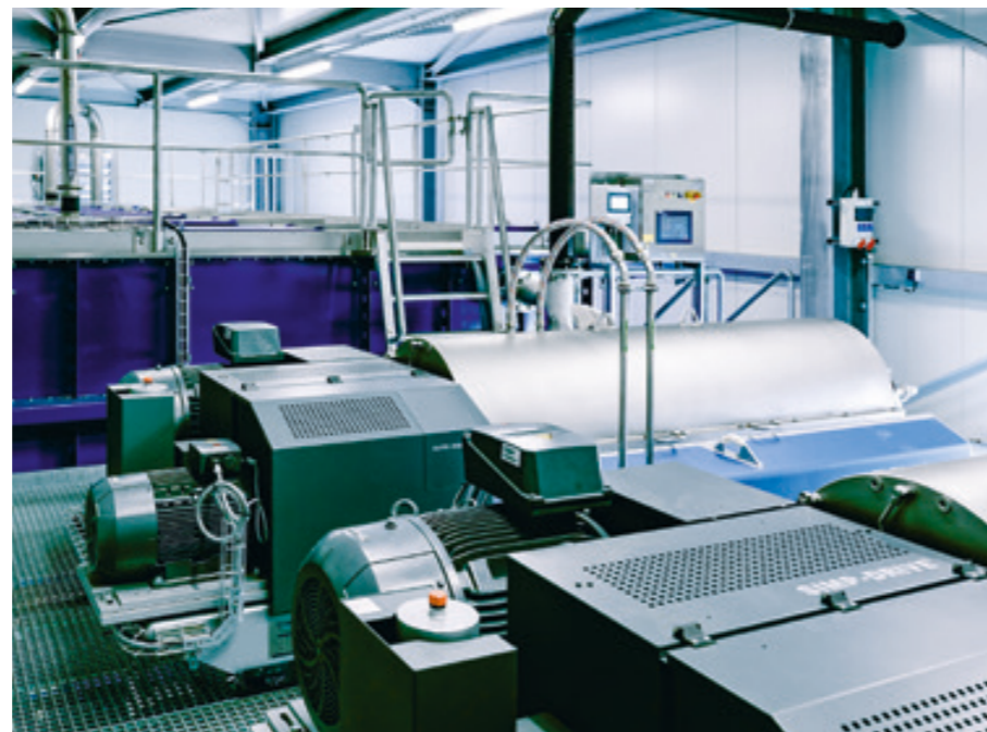
Mehrere Einreichungen zielten auf die Optimierung der neuen Dünnschlammmentwässerungsanlage.
