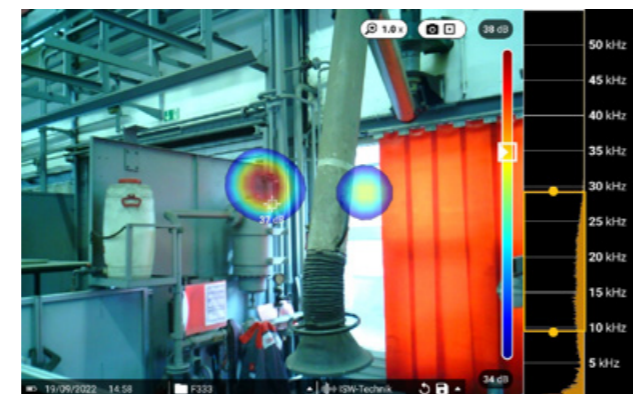
Visualisierung identifizierter Druckluftverluste mithilfe einer Schallkamera (Teilprojekt 2).
